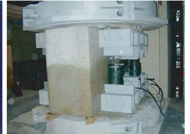
Sanierung der Säule West 3: Drei neue Natursteinblöcke wurden nacheinander eingebaut und zu einer neuen Trommel geformt Foto: GSE Ingenieur-Gesellschaft mbH Saar, Enseleit und Partner
