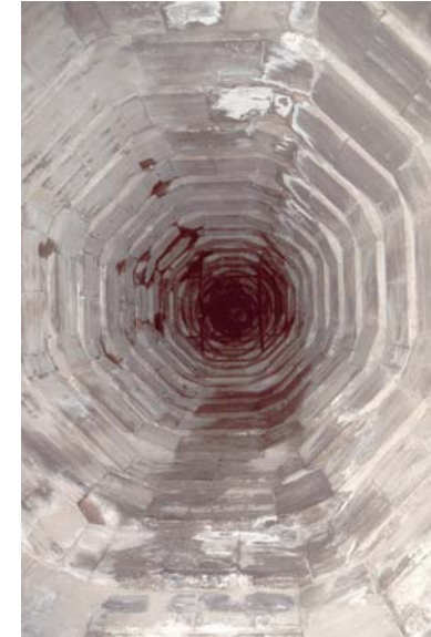
Südturm innen mit Feuchteschäden vor Sanierung . Foto H & K GmbH
